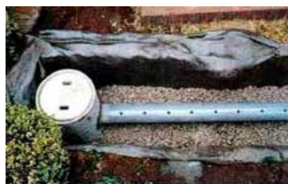
＜敷地内の雨水浸透トレンチ＞
