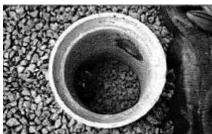
＜敷地内の雨水浸透柵＞
