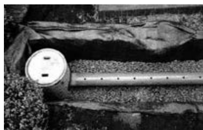
＜敷地内の雨水浸透トレンチ＞
