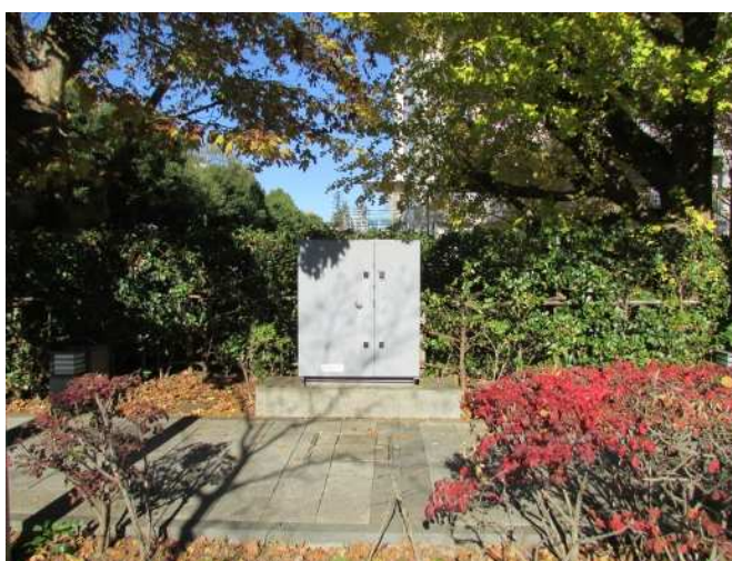
民地や公共用地を活用した地上機器設置の事例
