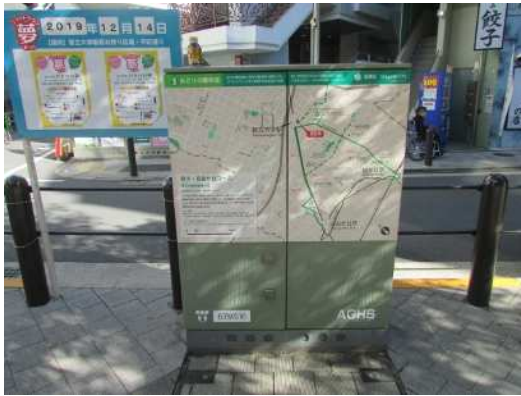
地上機器ラッピングの事例(都立大学駅)
