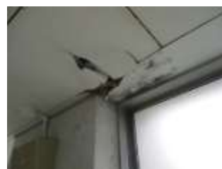
天井雨漏り・内装の劣化
