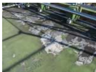
屋上防水の剥れ
