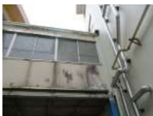
外壁塗装の剥れ
