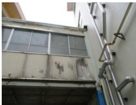
外壁塗装の剥れ
