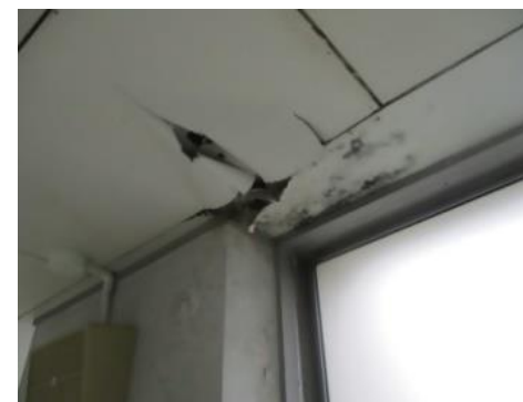
天井雨漏り・内装の劣化
