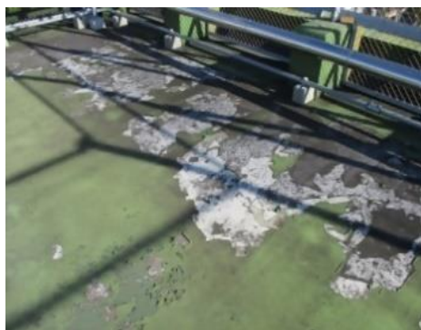
屋上防水の剥れ
