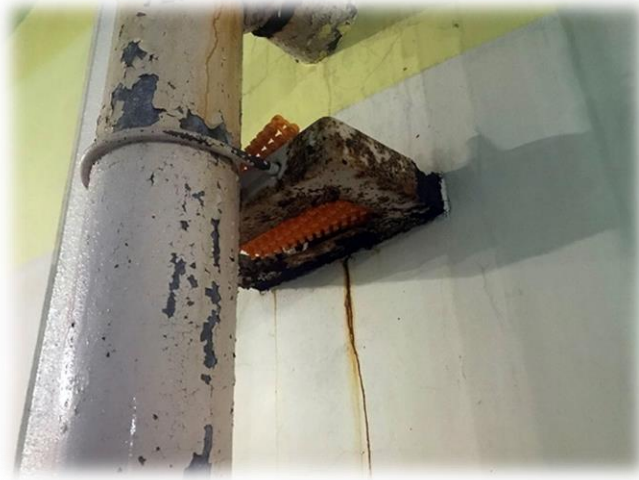
【屋内プール】コンクリートのひび割れ、配管支持金具の錆
