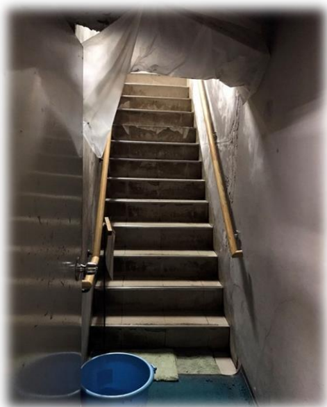
【ホール】 地下の水漏れ
