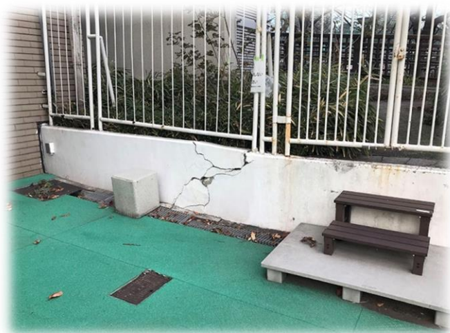
【屋外プール】コンクリートのクラック
