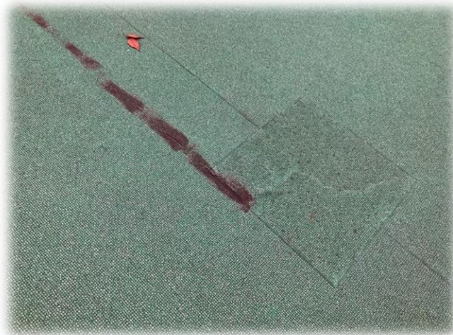
【屋外プール】プールサイドのビニルシートのはがれ
