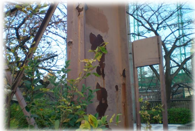
【屋外プール】ナイター照明の塗装の剥がれ及び錆
