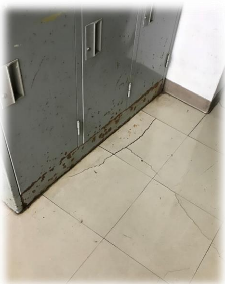
【ホール】 楽屋床材のクラック
