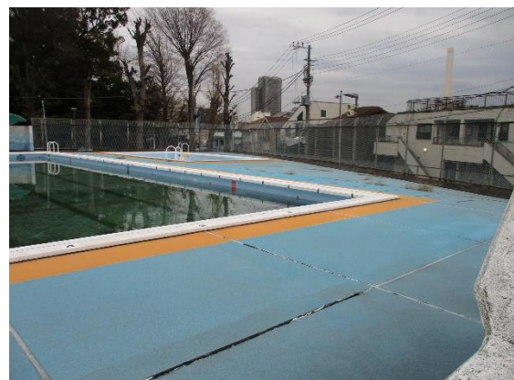
プールサイドの劣化
