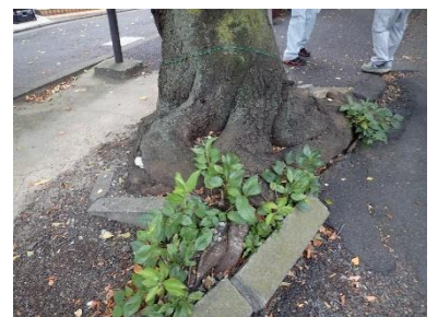
根による舗装縁石破損
