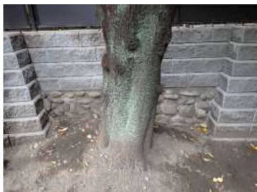
三田公園 近隣隣接植栽帯 地際部が擁壁に接触する
