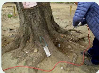
ファインノズルによる圧縮空気をを用いた 細縦穴掘削作業中
