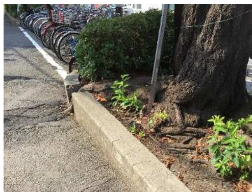
露出根により歩道の凸凹が生じている
