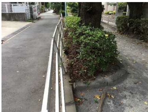
露出根や幹の肥大により縁石を押し 広げフェンスがゆがんでいる
