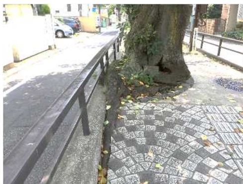
根が縁石や舗装を破壊し始めている状況
