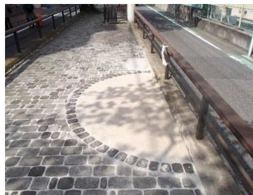
歩行者の安全のため、伐採後一時的に土系舗装を行っている場所
