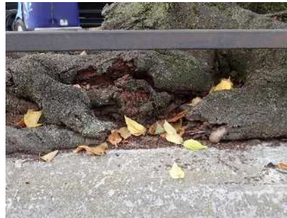
根が傷付き、腐朽が発生
