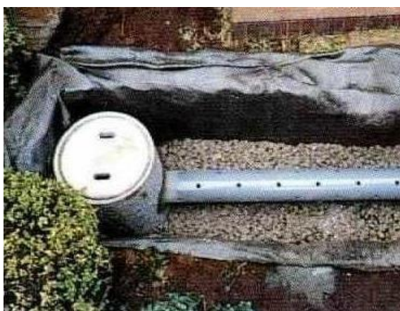
＜敷地内の雨水浸透トレンチ＞
