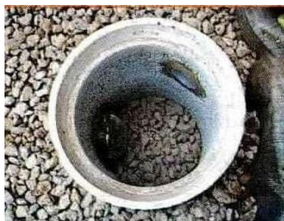
＜敷地内の雨水浸透柵＞
