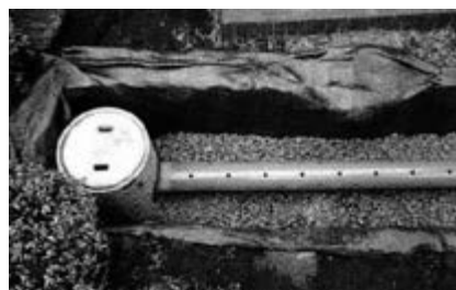
＜敷地内の雨水浸透トレンチ＞
