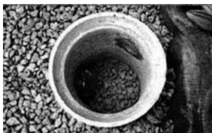
＜敷地内の雨水浸透柵＞
