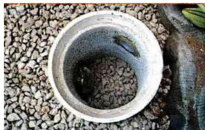
＜敷地内の雨水浸透柵＞
