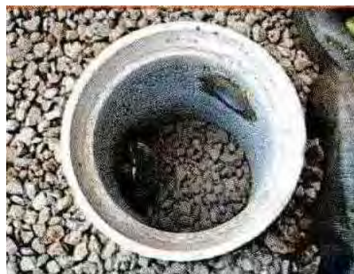
<敷地内の雨水浸透柵>
