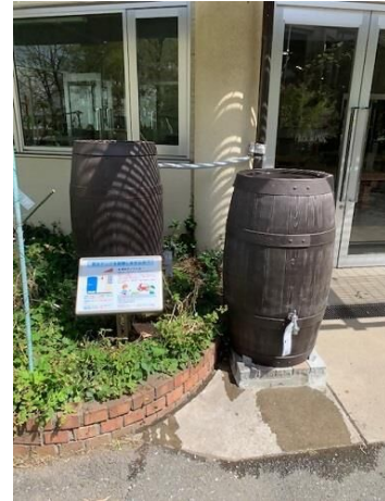
<中目黒公園 雨水タンク>
