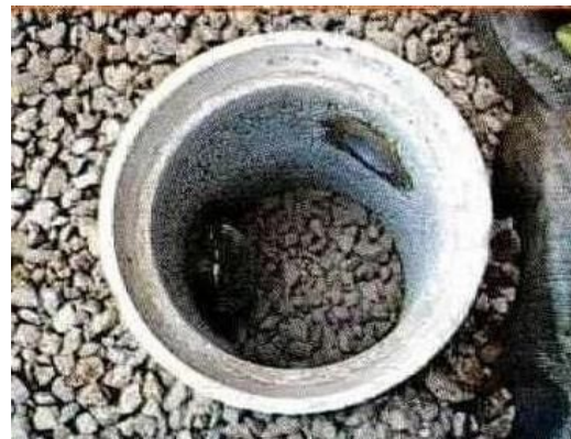
<敷地内の雨水浸透柵>
