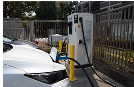
● 超急速充電設備 ●
