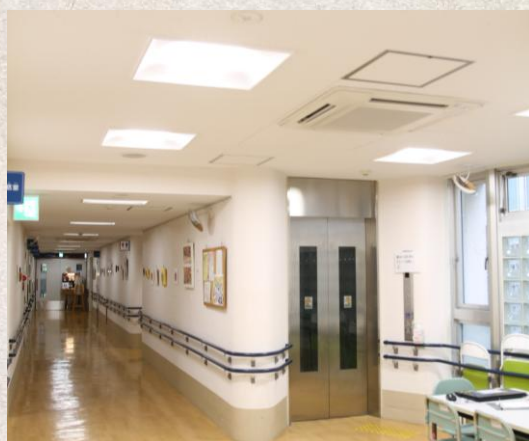
下目黒福祉工房 LED照明
