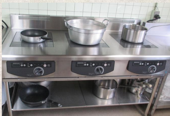
すくすくのびのび園 IH調理器
