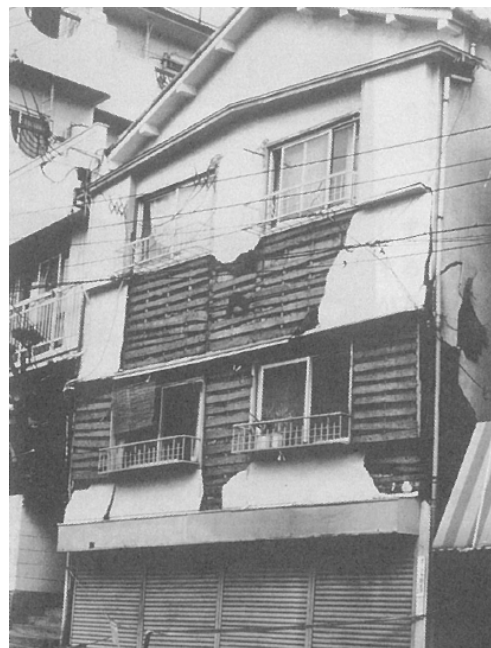
【6】 壁の被害の例（Cランク）
