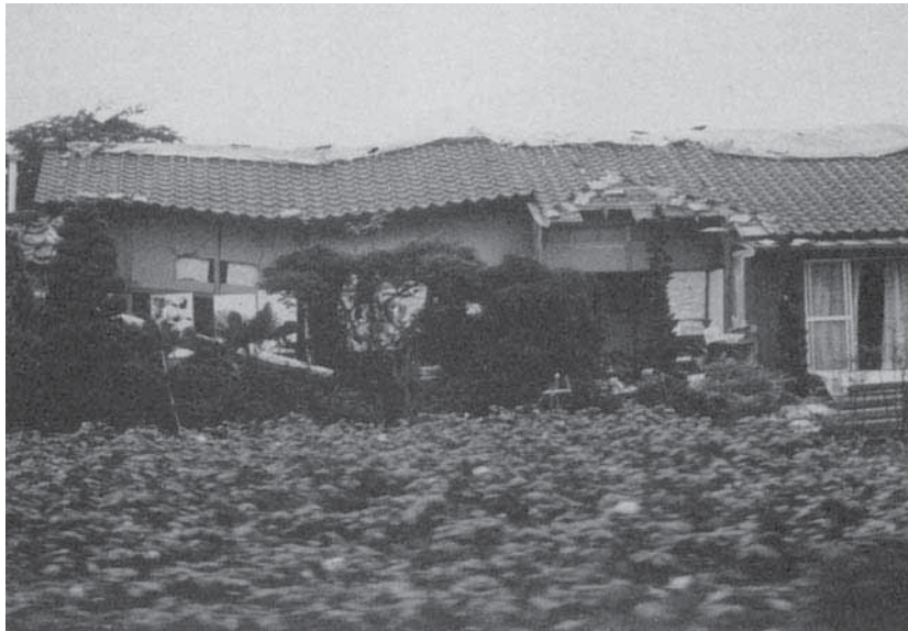
写真－4 建築物の不同沈下（ランクB）
