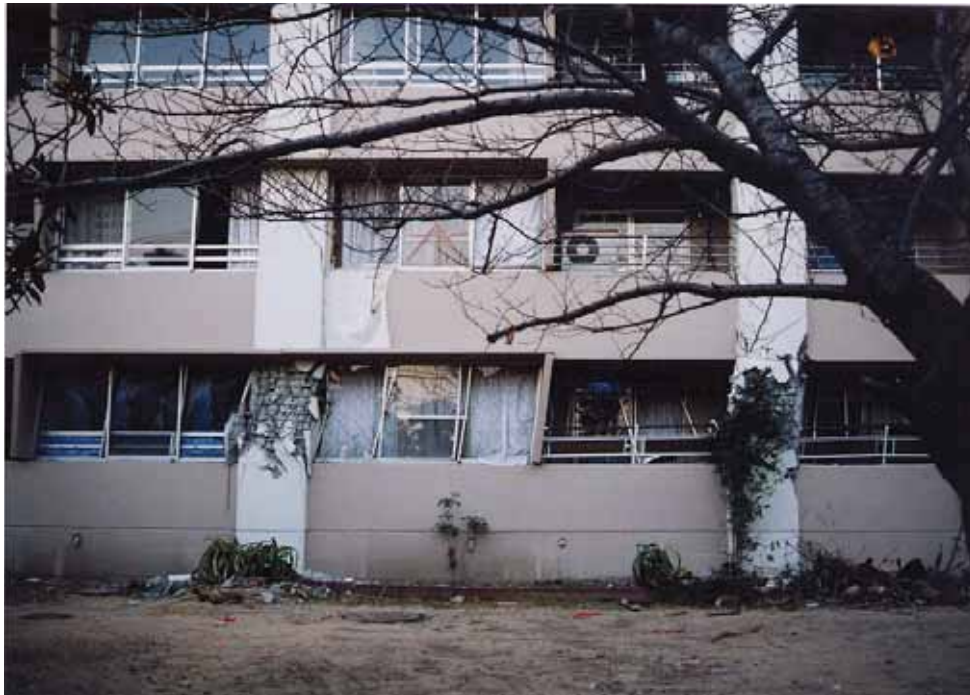
(d) 柱の損傷に伴う大きな水平変形の被害例（1995年・兵庫県南部地震）
