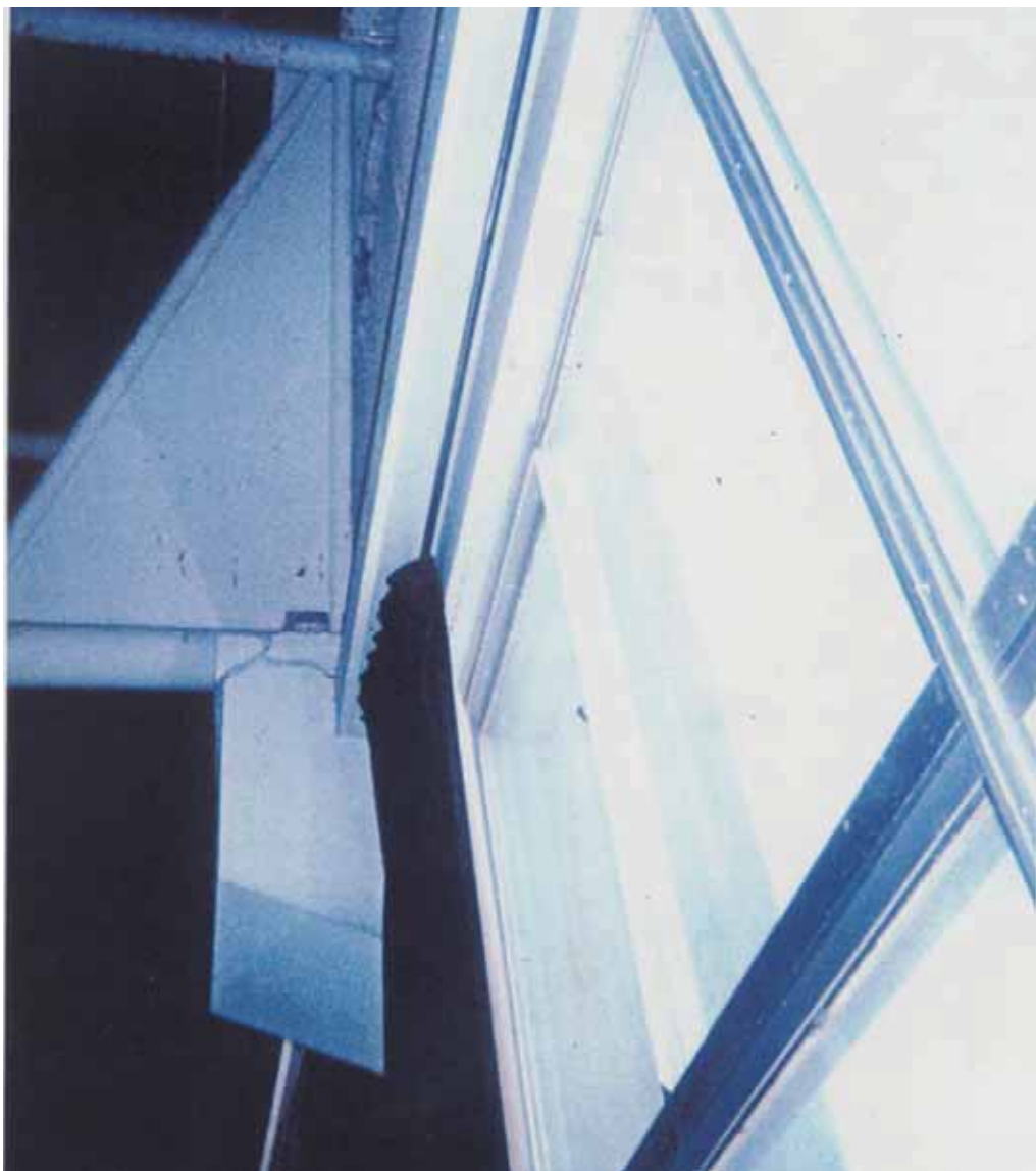
写真ー 1 2 鉄骨屋根定着部の損傷によるコンクリート片の落下危険性（兵庫県南部地震、東大生研大井研提供）
