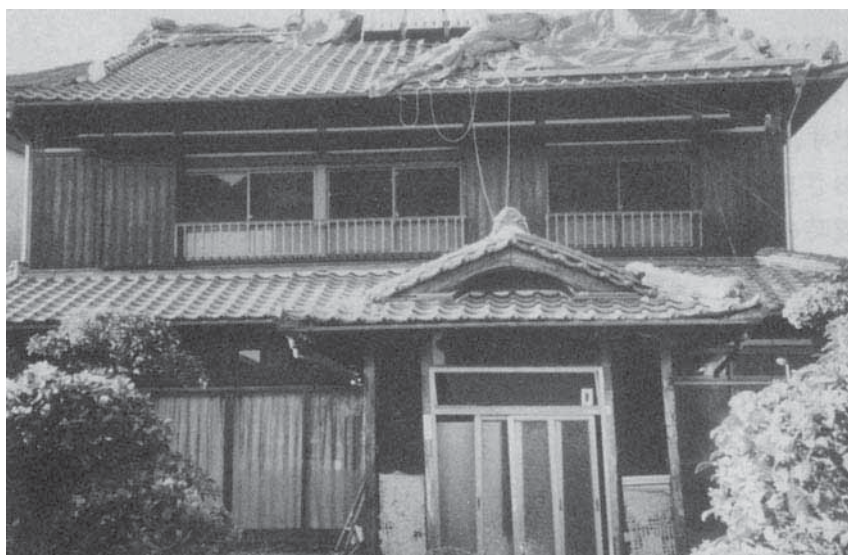
写真-7 建築物の1階の傾斜（ランクB）
