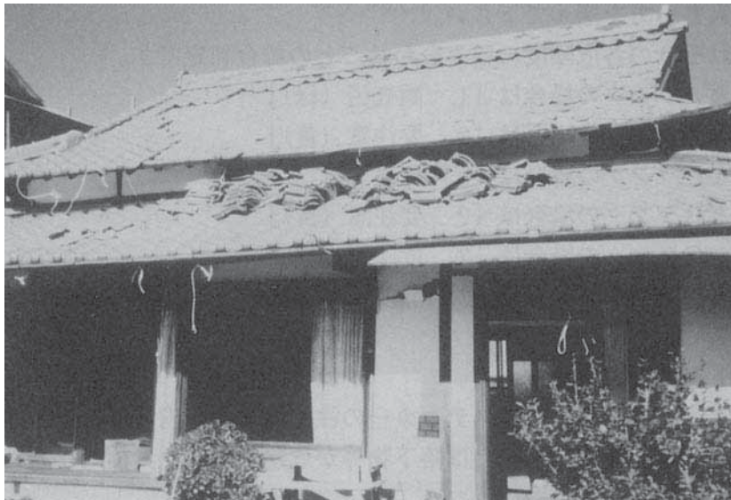
写真-17 落下危険物（瓦）（ランクB）
