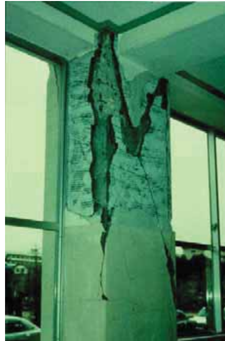
(b) 仕上げコンクリートはかなり剥落しているが、柱躯体のコンクリートの剥落は少ない。鉄筋が僅かに露出しているが変形は見られない。
