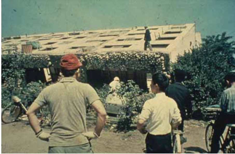
図一五 全体沈下と全体傾斜の被害例（1964年・新潟地震／東大 梅村・大澤研究室）
