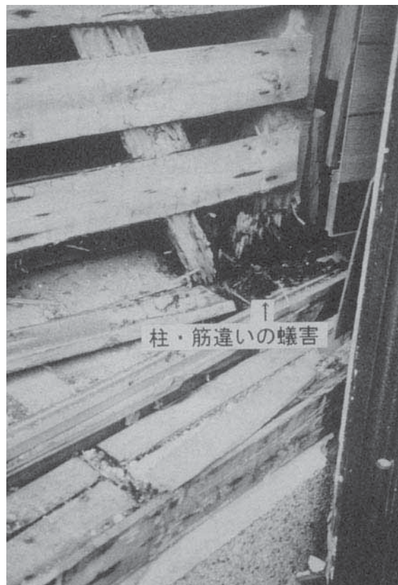
写真-15 蟻害 (ランクC)
