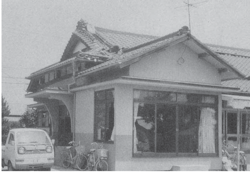
写真-16 落下危険物（瓦）（ランクA）
