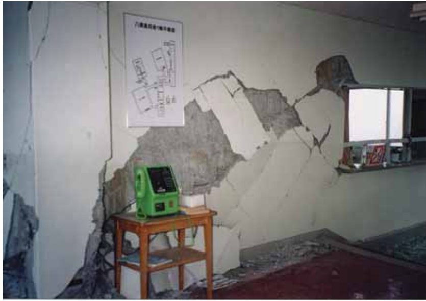
(a) 仕上げコンクリートの剥落が激しく、幅 2mm を超える斜めひび割れが多数発生しているが、鉄筋の座屈や破断は見られない。(1994 年・三陸はるか沖地震)
