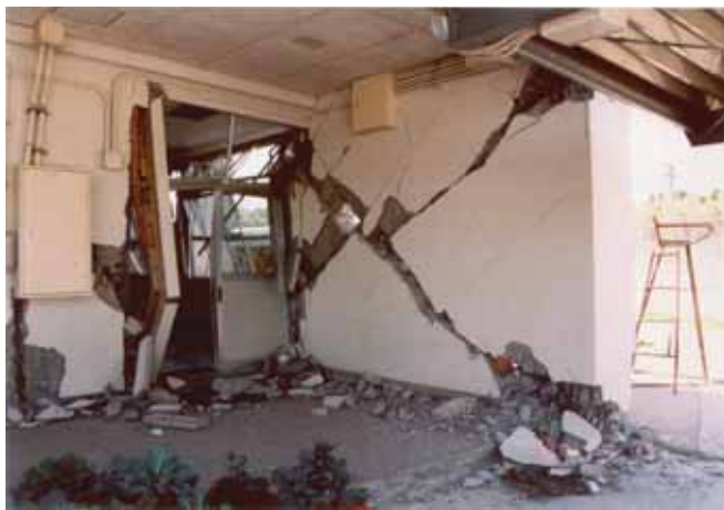
(a) 壁に大きなせん断ひび割れが生じ、壁の向こうが透けて見える。壁や柱の鉄筋も大きく曲がっている。 (1997年・鹿児島県北西部地震)
