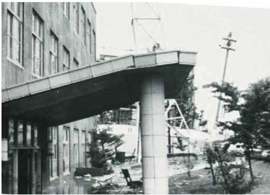
図-7 全体沈下が1mを超える被害例 (1964年・新潟地震／芝浦工大・岡田研究室)
