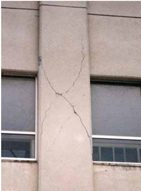
(a) 柱に X 字型の斜めひび割れが生じている。仕上げコンクリートのひび割れは著しいが、柱躯体のひび割れ幅は 2mm 程度である。(1995 年・兵庫県南部地震／東北大 前田研究室)
