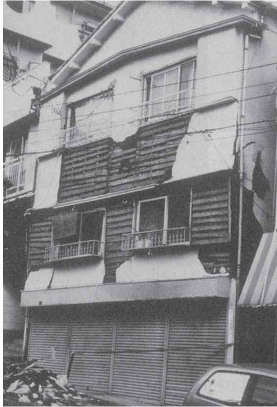
写真-13 壁の被害（外壁、ランクC）
