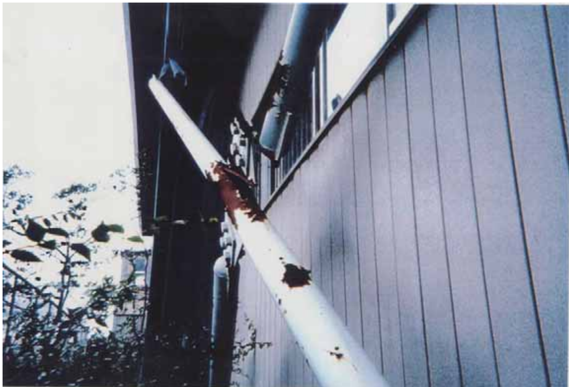
写真一4 鋼管筋違交差部の破断 (兵庫県南部地震、東大生研大井研)
