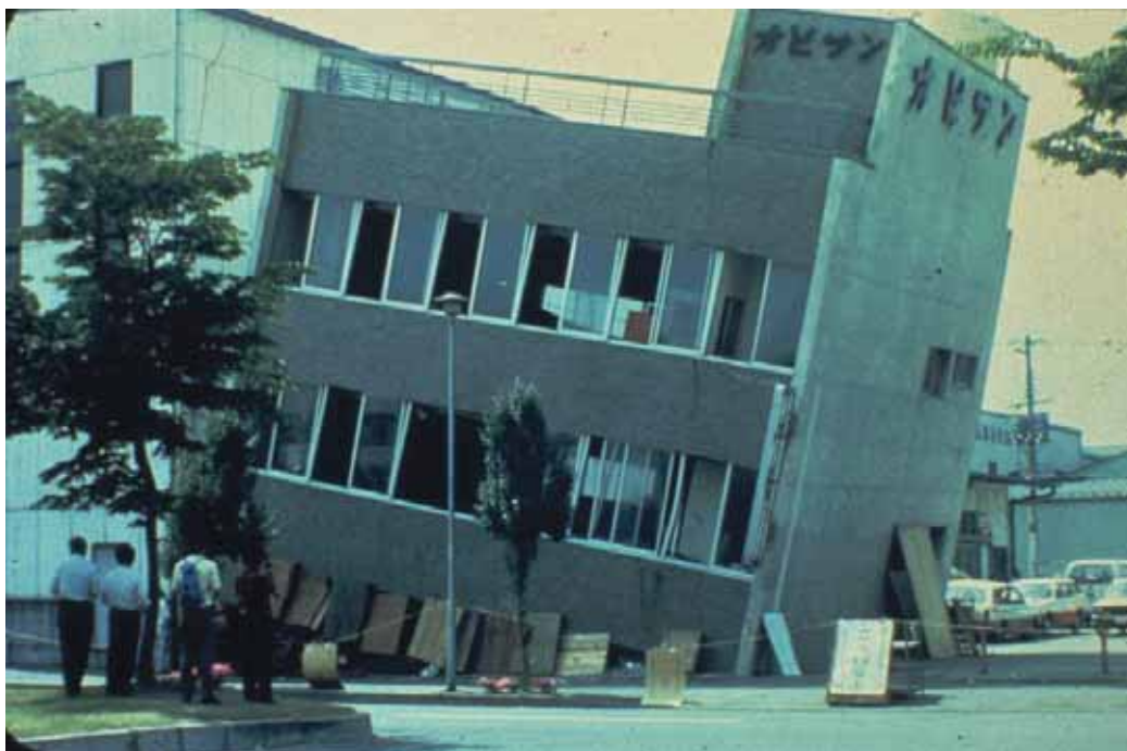
(b) 1階柱の破壊による部分傾斜の被害例 (1978年・宮城県沖地震)
