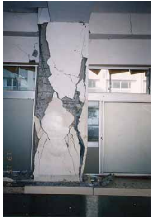
(c) 激しいコンクリートの剥落が見られ、鉄筋がかなり露出しているが、座屈や破断はみられない。(1995 年・兵庫県南部地震／東北大 前田研究室)
