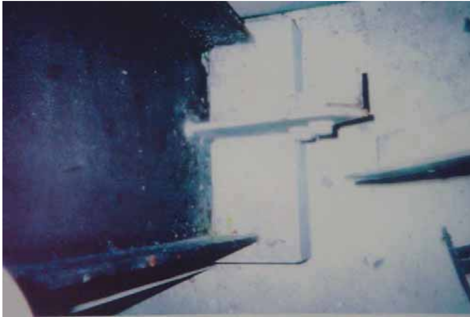
写真－5 山形鋼筋違端部の破断 (兵庫県南部地震、東大生研大井研)
