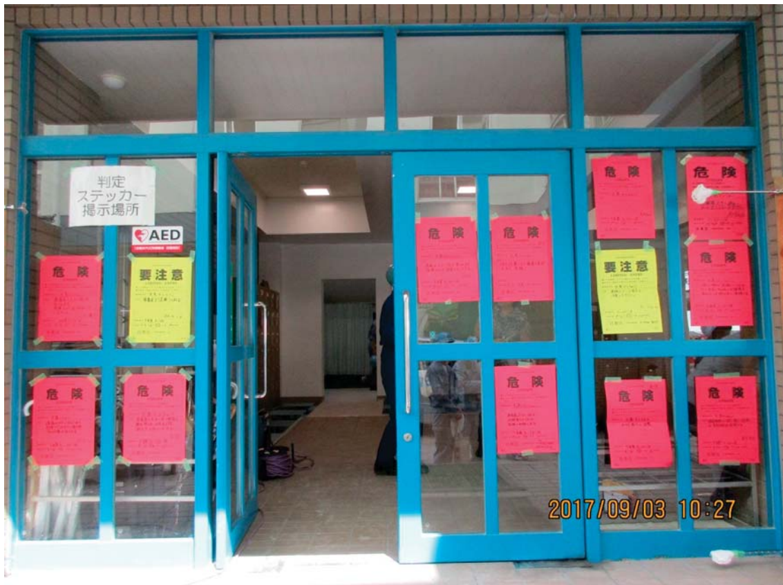
判定ステッカーの記入・表示状況
