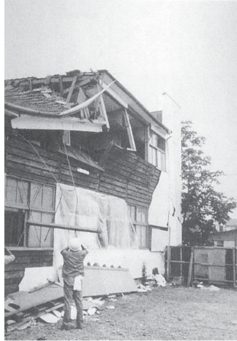
不同沈下の例（Cランク） 2階、小屋組みの破壊
