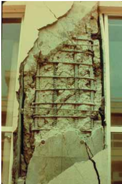
(b) 2mm を超えるひび割れが生じ、コンクリートが剥落して鉄筋が見えるが座屈等の変形は見られない。(1978 年・宮城県沖地震)
