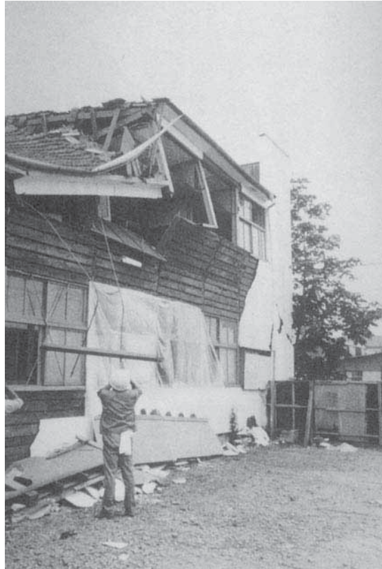
写真－5 建築物の不同沈下（ランクC）
