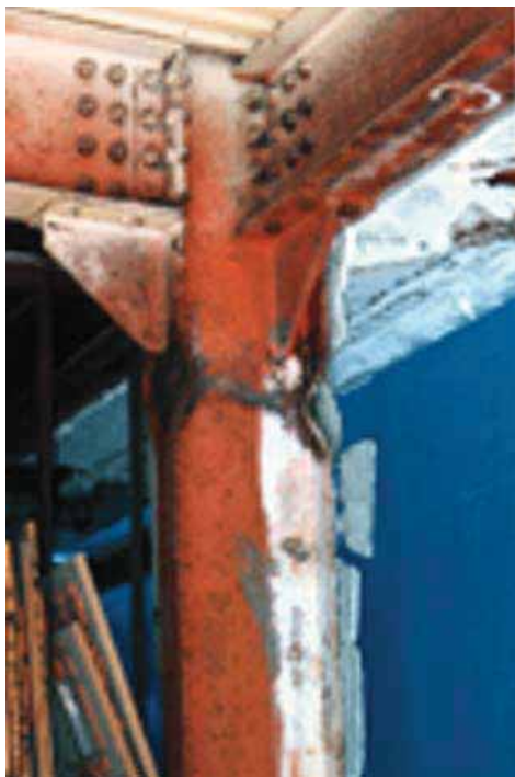
写真二 鋼管柱の局部座屈 (兵庫県南部地震)
