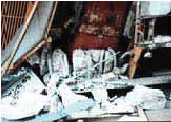
写真一8 根巻き柱脚の移動 (兵庫県南部地震)
