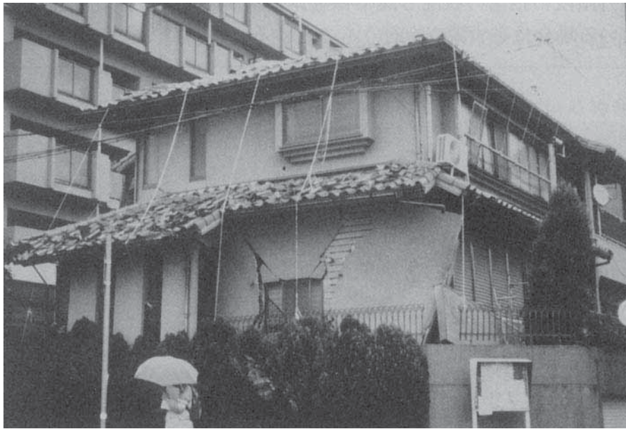
写真-18 落下危険物（瓦）（ランクC）
