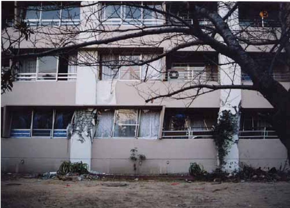
(d) 柱の損傷に伴う大きな水平変形の被害例（1995年・兵庫県南部地震）
