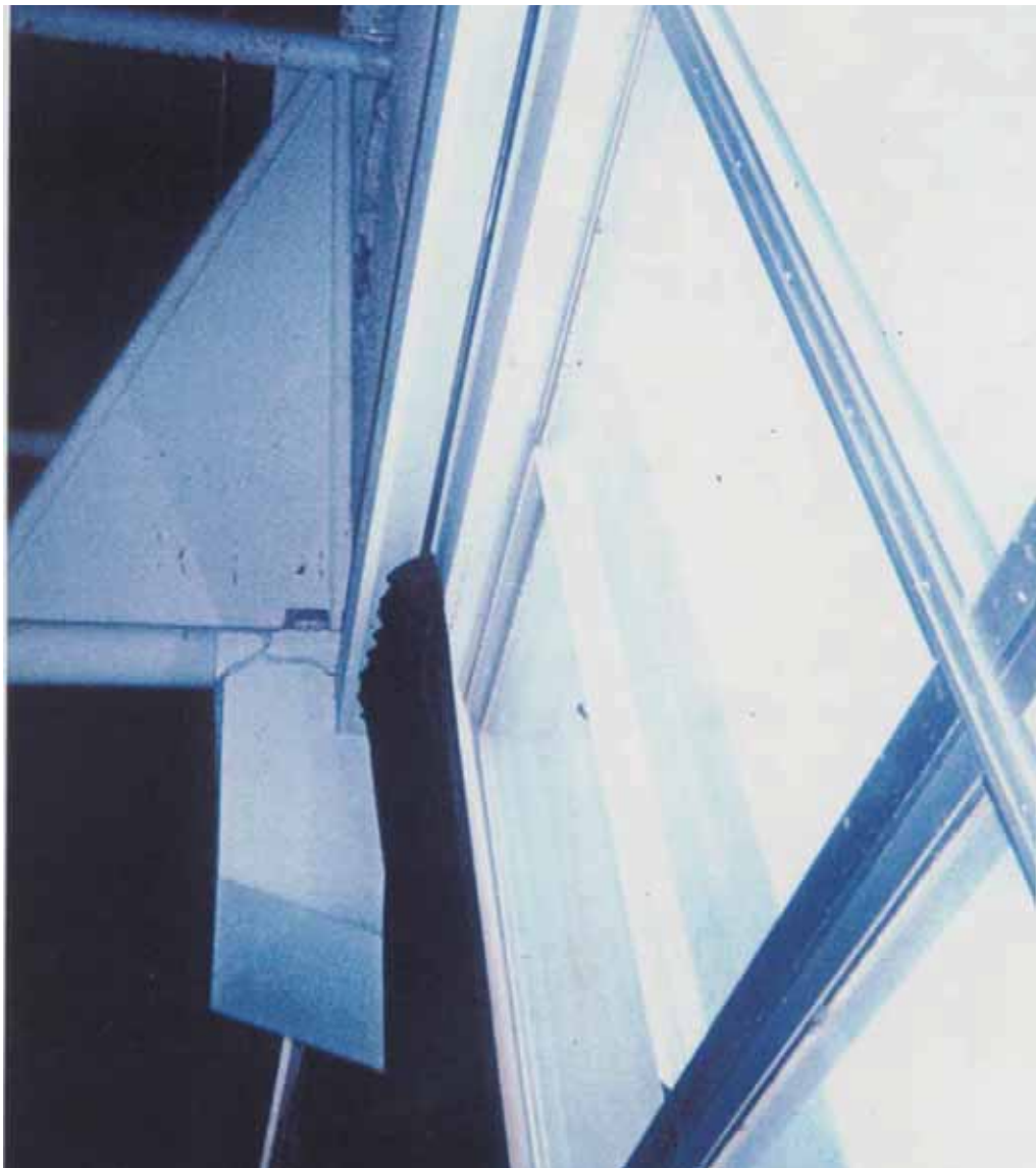
写真－１２ 鉄骨屋根定着部の損傷によるコンクリート片の落下危険性（兵庫県南部地震、東大生研大井研提供）
