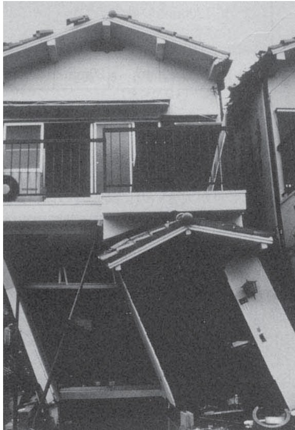
写真-8 建築物の1階の傾斜（ランクC）
