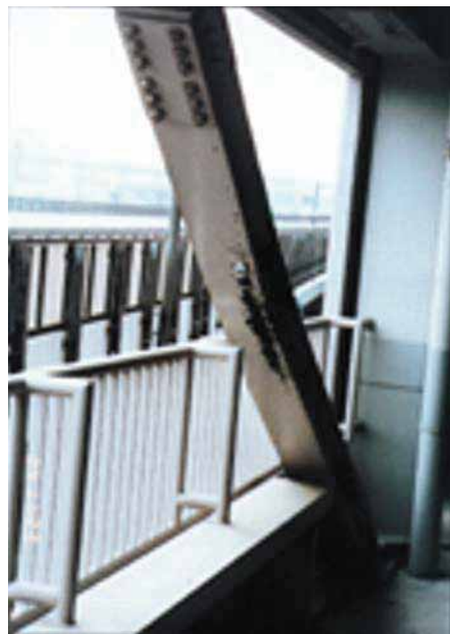
写真三 筋違の座屈 (兵庫県南部地震)
