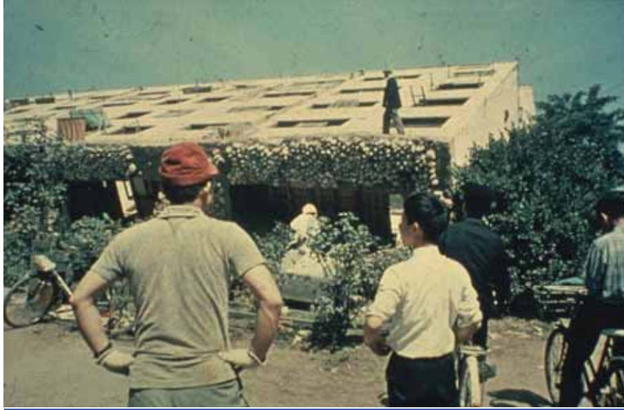
図一五 全体沈下と全体傾斜の被害例（1964年・新潟地震／東大 梅村・大澤研究室）
