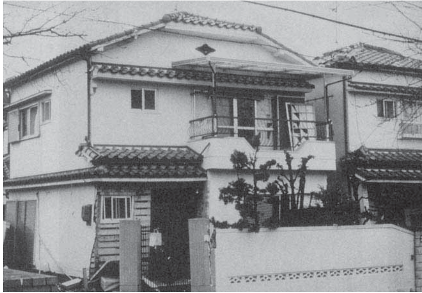
写真-9 壁の被害（外壁、ランクA）
