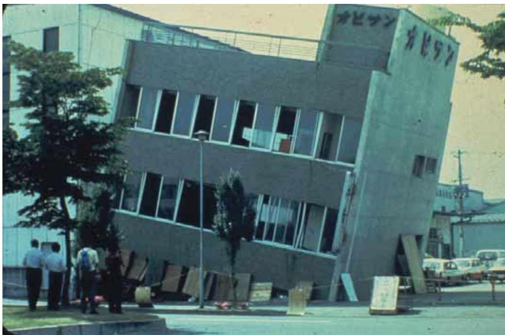
(b) 1階柱の破壊による部分傾斜の被害例 (1978年・宮城県沖地震)
