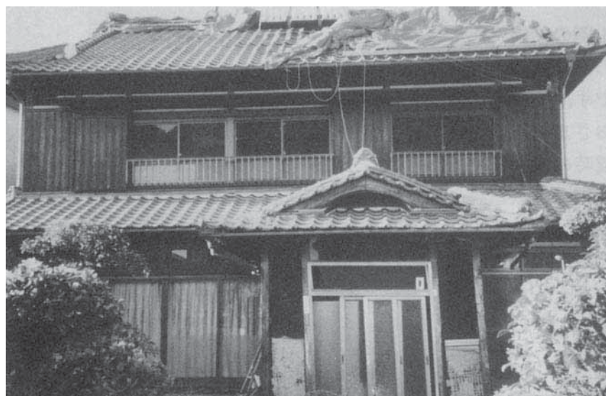
写真-7 建築物の1階の傾斜（ランクB）
