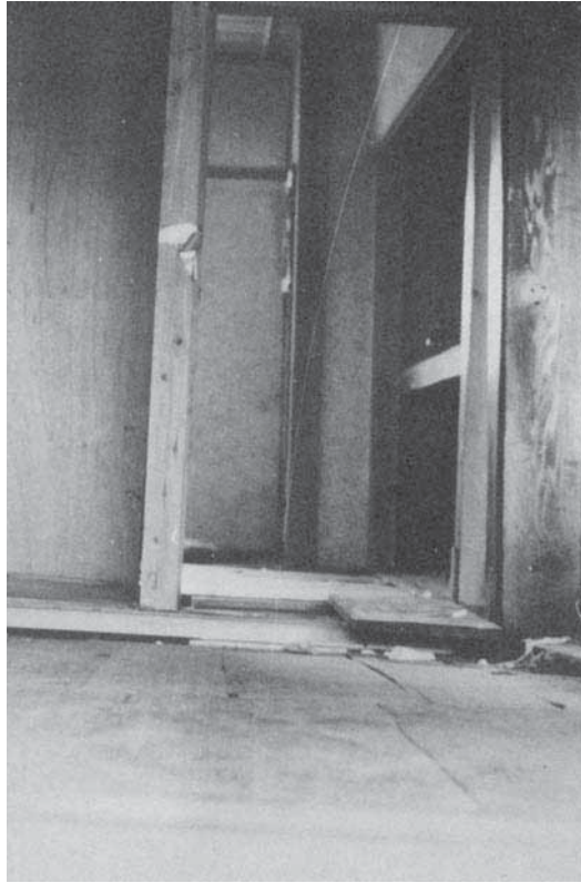
写真－3 建築物の不同沈下（ランクA）
