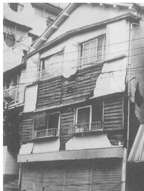
【6】 壁の被害の例（Cランク）
