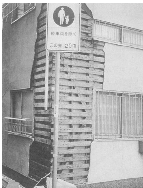
【5】 壁の被害の例（Bランク）
