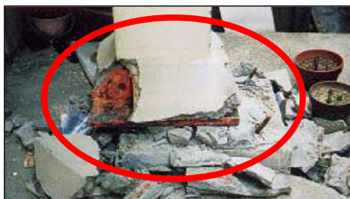
柱脚の破損その2
