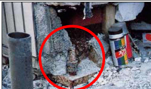
柱脚の破損その1
