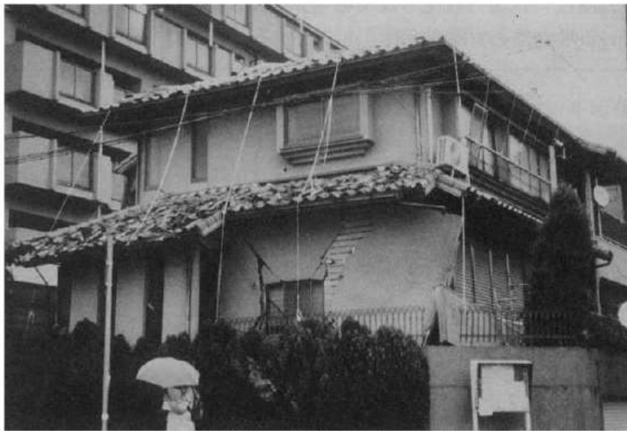
写真-18 落下危険物（瓦）（ランクC）
