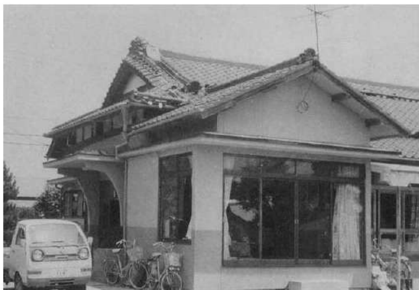
写真-16 落下危険物（瓦）（ランクA）
