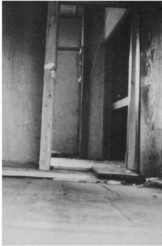
写真-3 建築物の不同沈下（ランクA）
