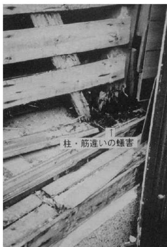
写真-15 蟻害（ランクC）
