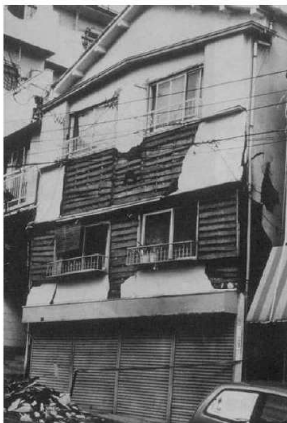
写真-13 壁の被害（外壁、ランクC）
