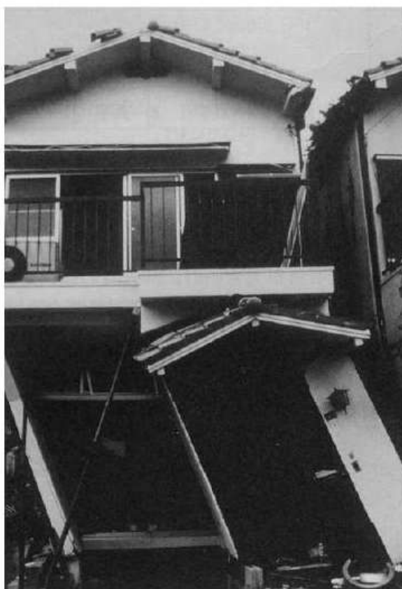
写真一8 建築物の1階の傾斜（ランクC）
