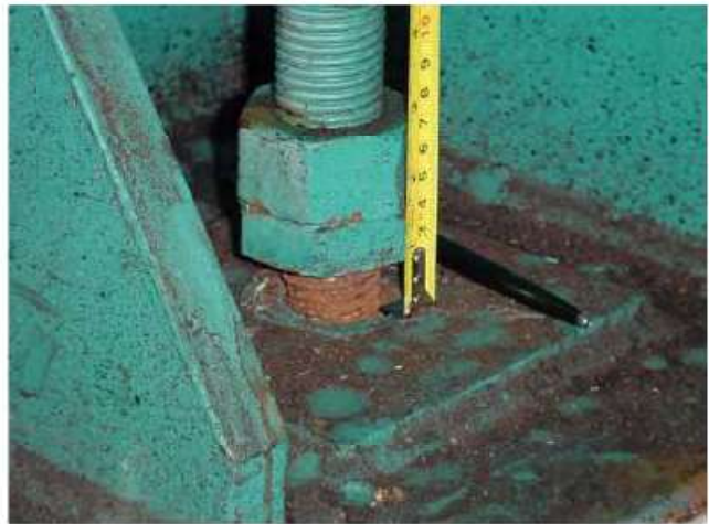
写真—10 筋違を受ける露出型柱脚のアンカーボルト降伏 (ペルー南部 (Atico) 地震、東大生研大井研撮影)
