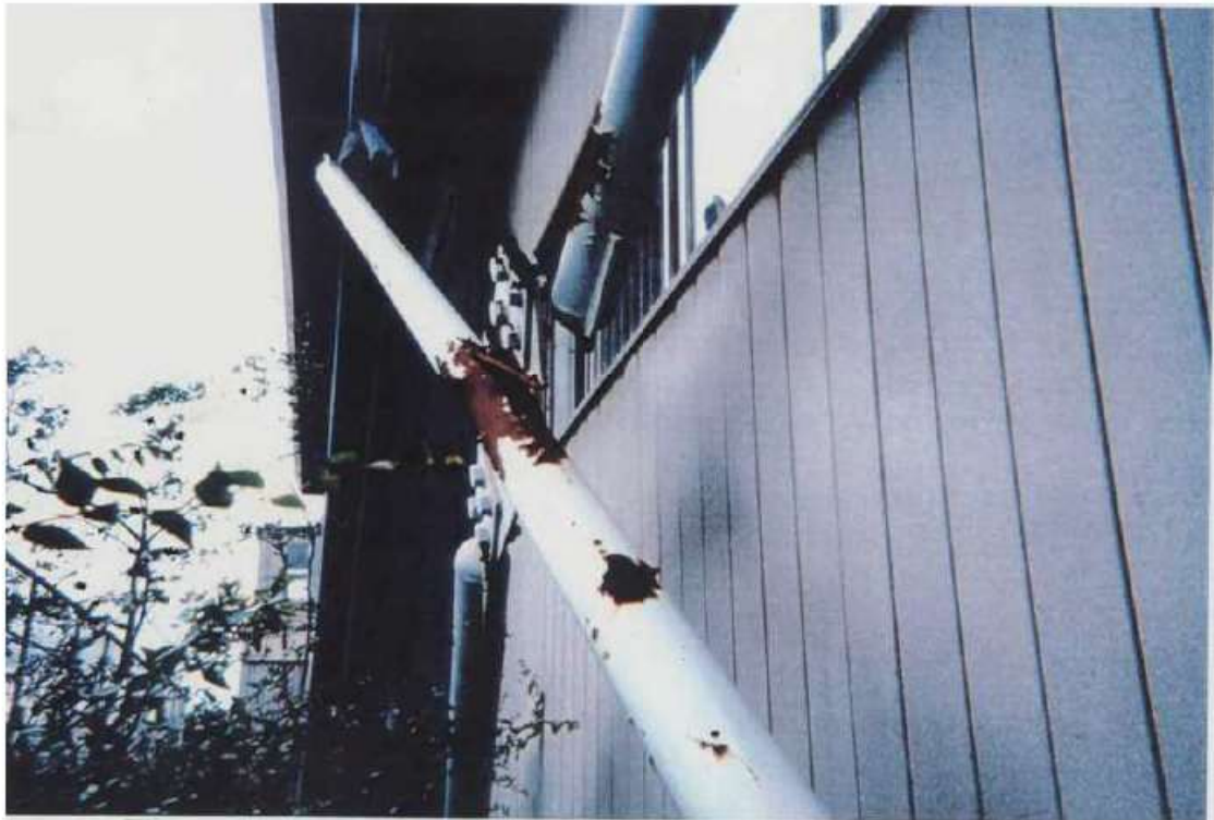
写真—4 鋼管筋違交差部の破断 (兵庫県南部地震、東大生研大井研)
