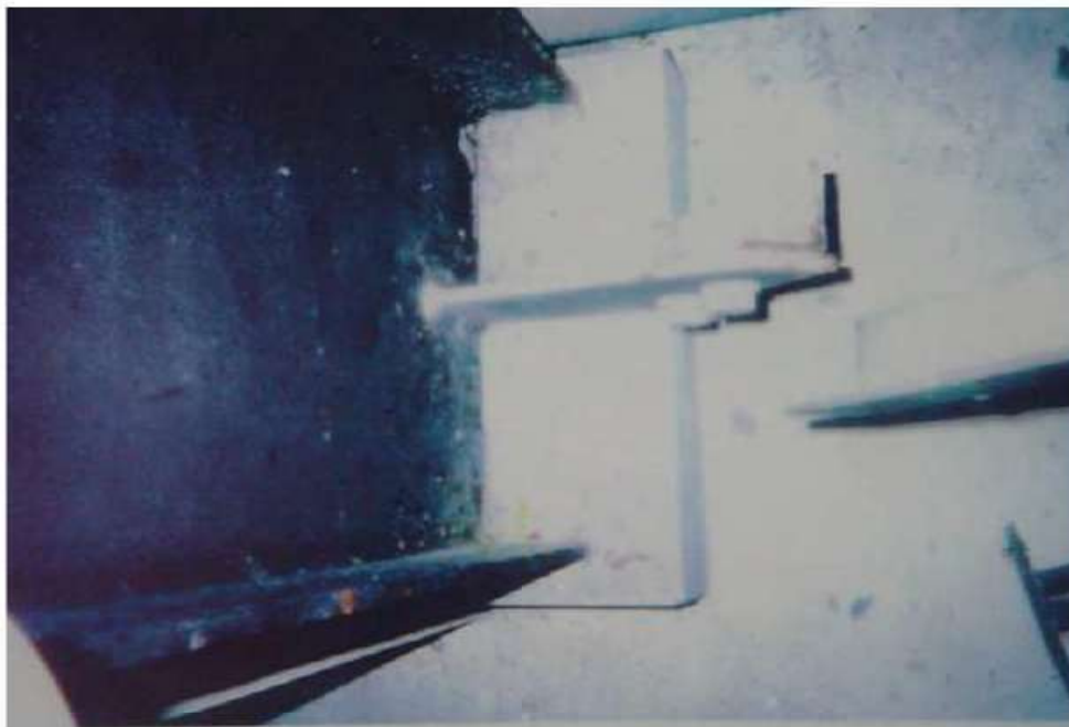
写真－５ 山形鋼筋違端部の破断 (兵庫県南部地震、東大生研大井研)
