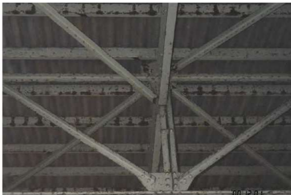
写真－１１ 屋根面ブレースの一部破断、ボルト等の落下の危険性がある。（鳥取県西部地震、東大生研大井研提供）
