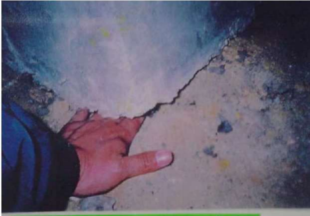
写真－１３ 屋内運動場の木造床を支える束立ての移動 (兵庫県南部地震 東大生研大井研)
