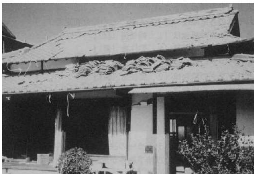
写真-17 落下危険物（瓦）（ランクB）
