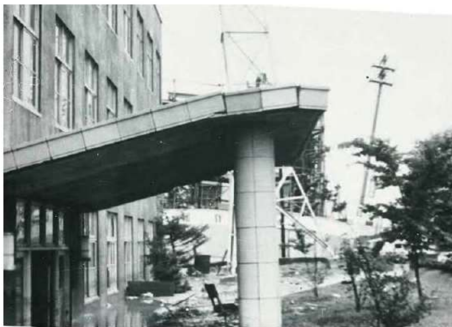
図一七 全体沈下が1mを超える被害例 (1964年・新潟地震／芝浦工大・岡田研究室)
