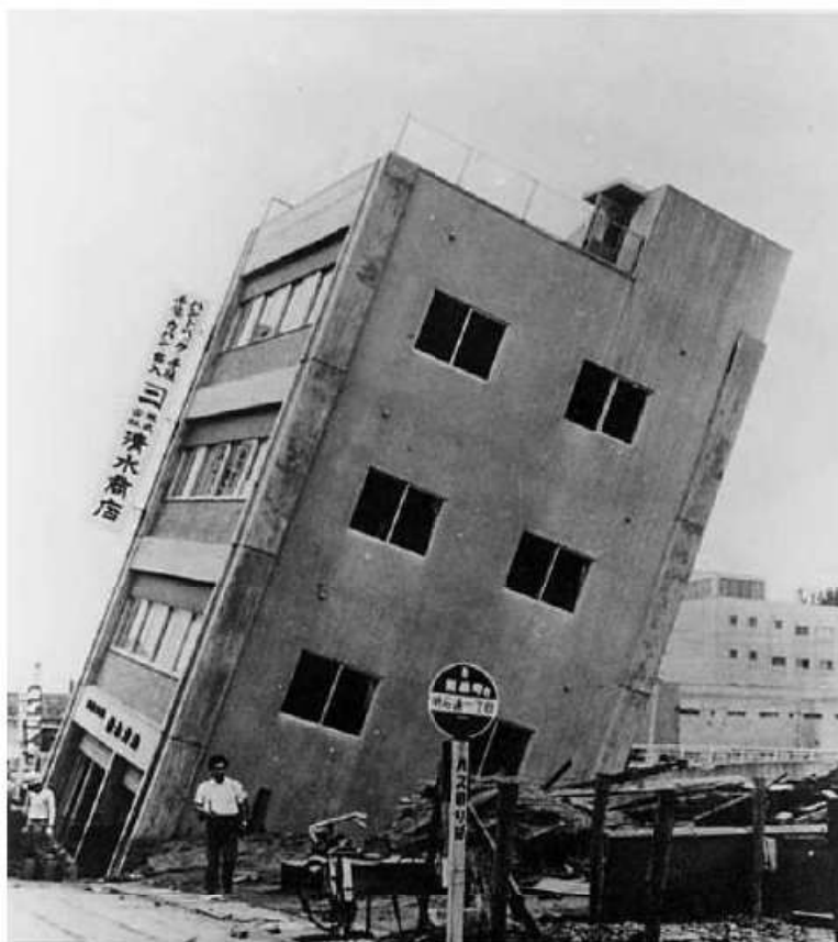
図一六 建物の全体傾斜が2度以上の被害例 (1964年・新潟地震／芝浦工大・岡田研究室)
