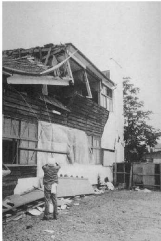
写真－5 建築物の不同沈下（ランクC）
