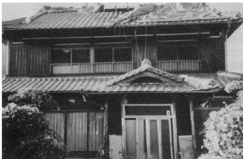
写真-7 建築物の1階の傾斜（ランクB）
