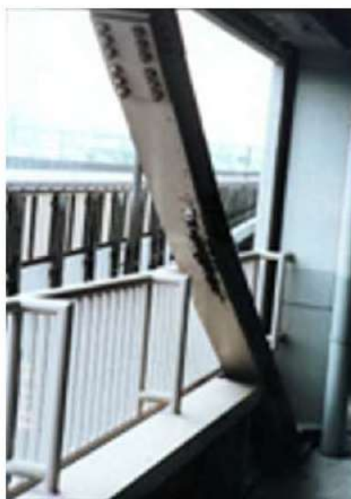
写真三 筋違の座屈 （兵庫県南部地震）
