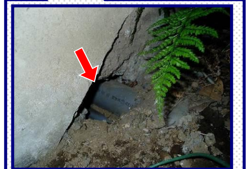
壁際の地面掘れ
