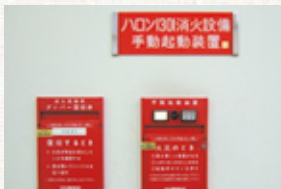
▲これがハロゲン化物消火設備のスイッチ
